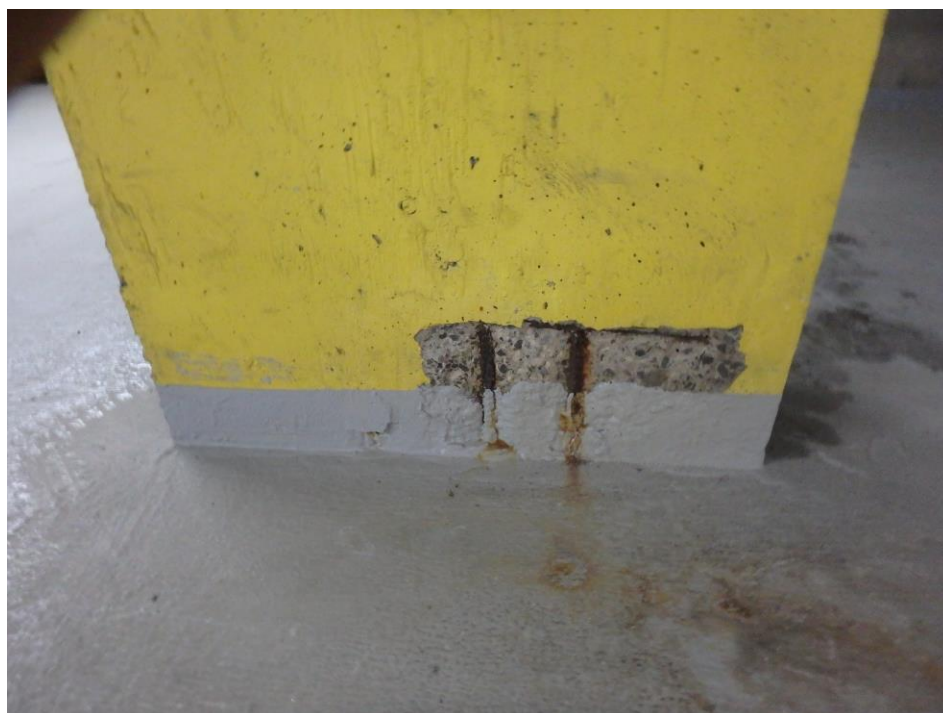
Photographie 4 : délamination du béton et corrosion des barres d'armatures visibles
