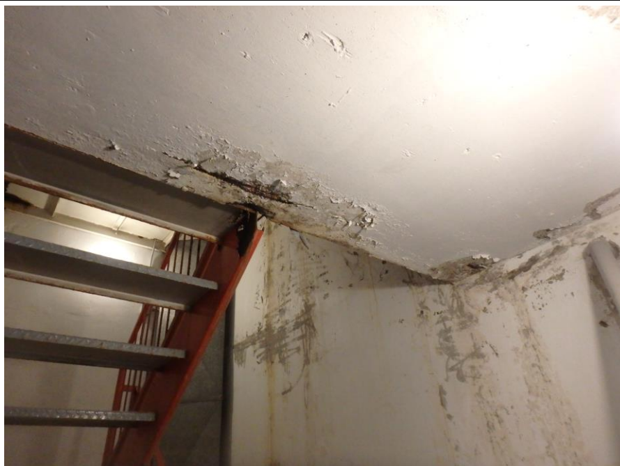
Photographie 7 : Délamination et trace de corrosion dans la cage d'escalier sud
