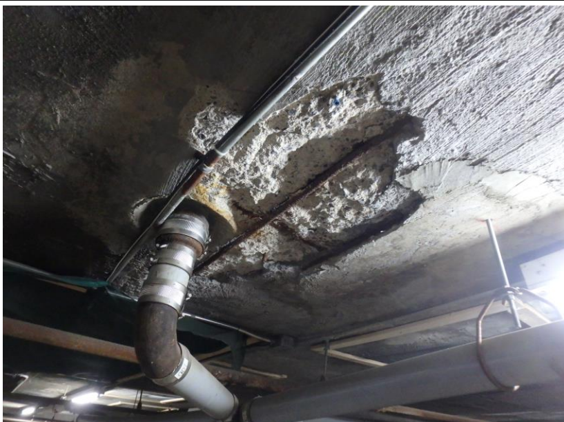
Photographie 1 : Délamination du béton et corrosion de l'acier d'armature
