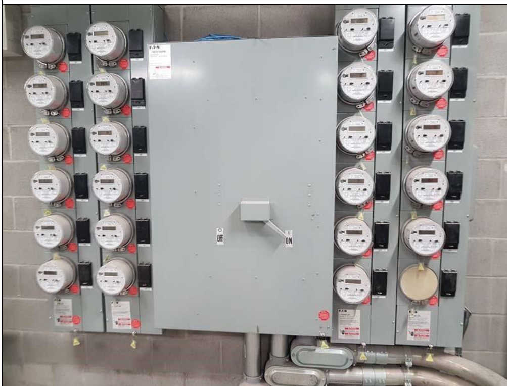
MODULE DE SERVICE PRINCIPAL, INTERRUPTEUR FUSIBLE PRINCIPAL 1 PHASE 1200A.
