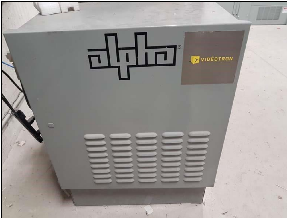
Transformateur de Vidéotron. Hors mandat.
