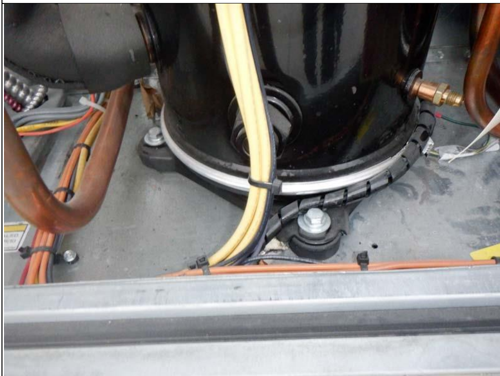
Ce compresseur est extrêmement bruyant et il est extrêmement chaud.
