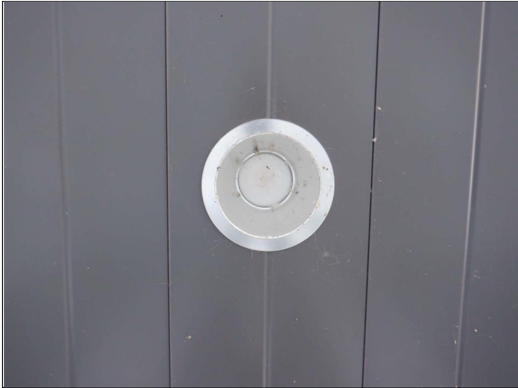
Lumière extérieure des marquises.
