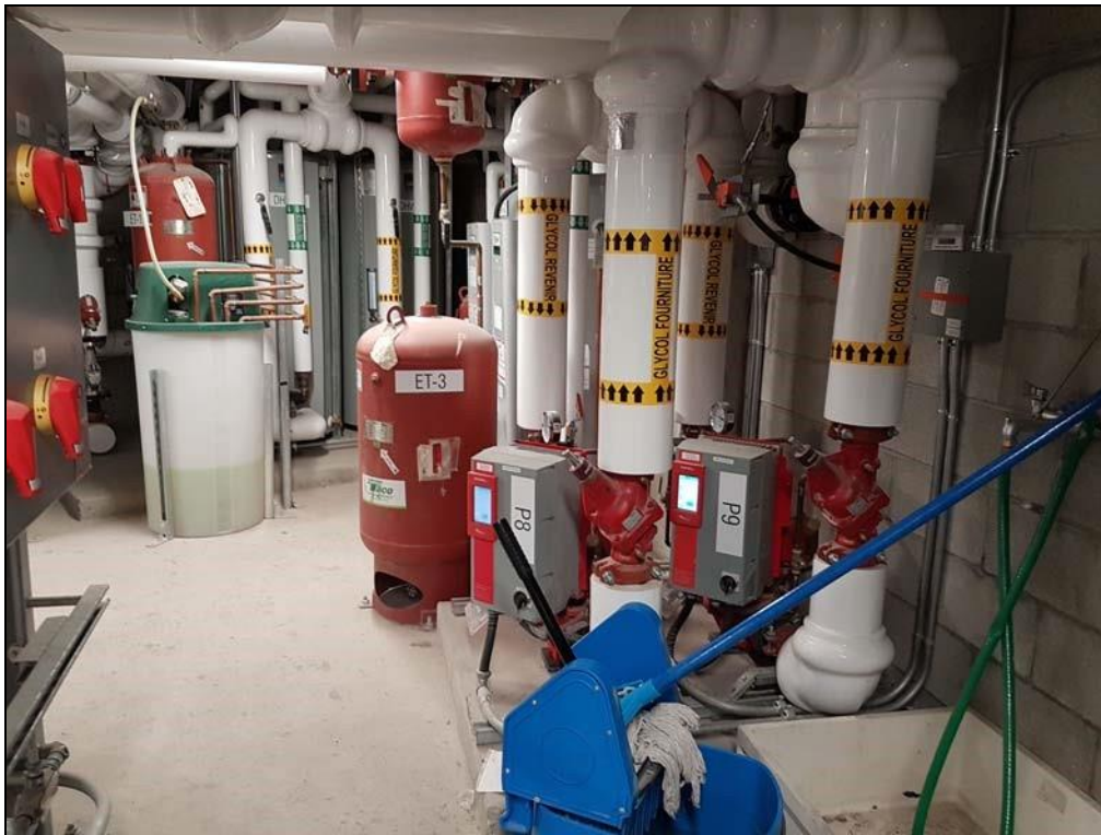
Vue générale Salle mécanique.
