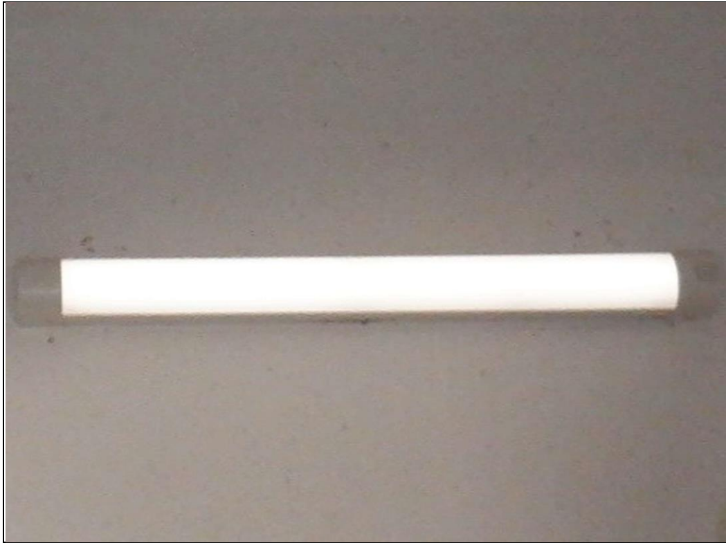
Néon dans les cages d'escaliers.
