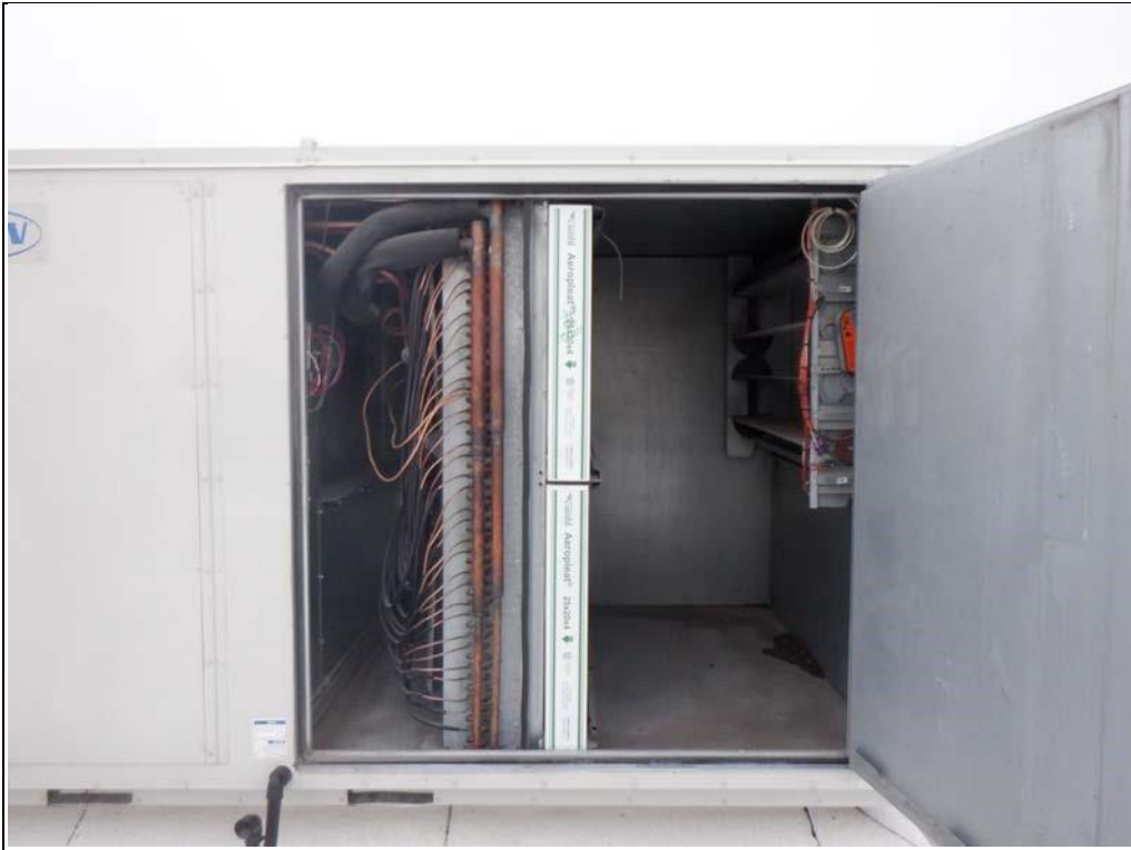
Unité de chauffage et de refroidissement.
