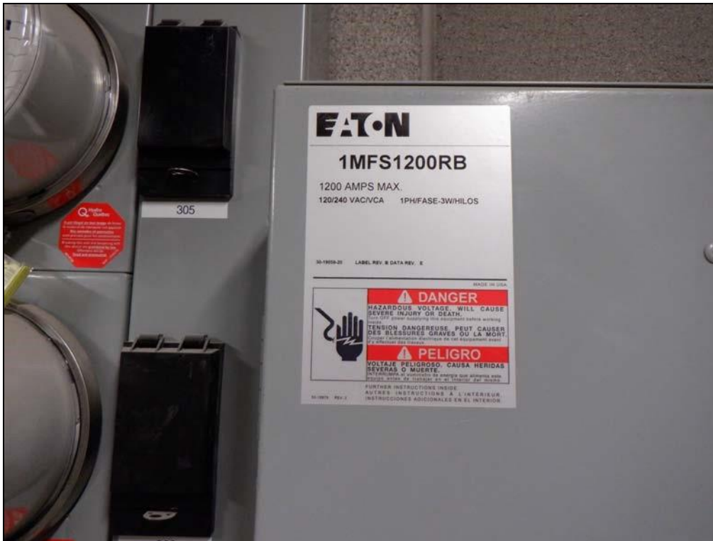
Module de service principal, interrupteur fusible principal 1. Phase 1200a Eaton 1mfs1200rb.
