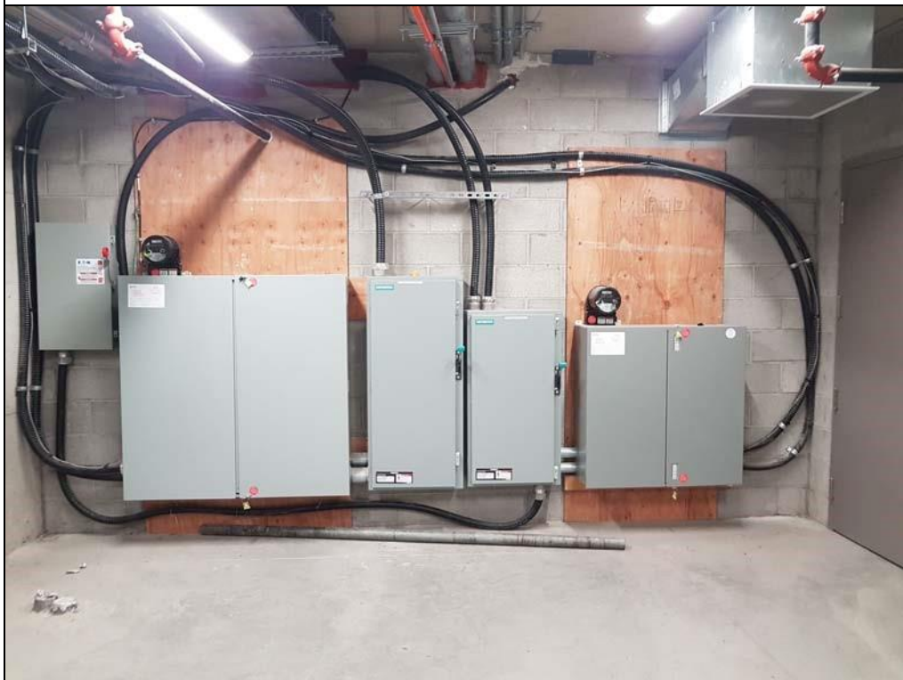
Vue du mur situé en façade dans la salle électrique du P-2.
