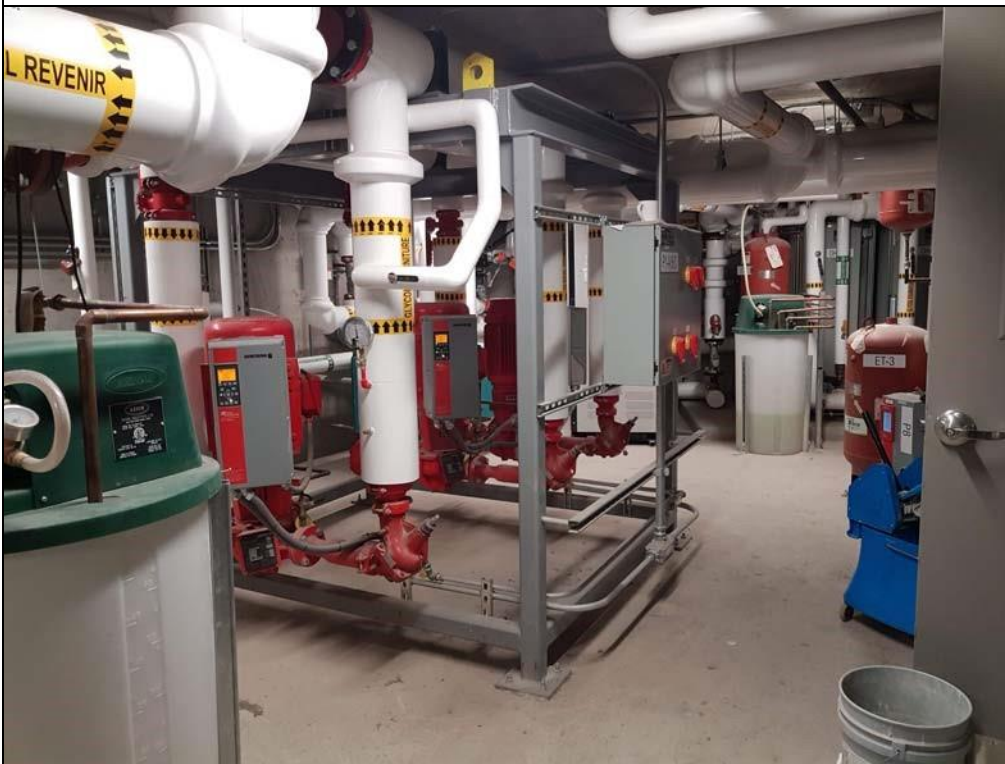
Vue générale de la salle mécanique.
