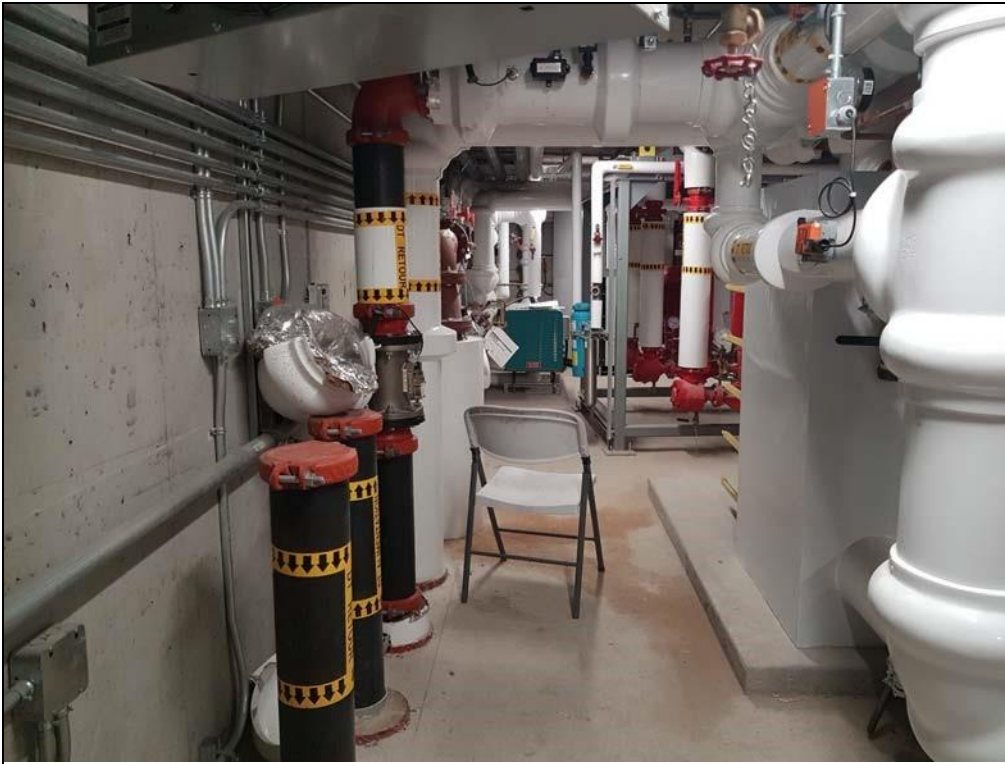
Vue générale de la salle mécanique.
