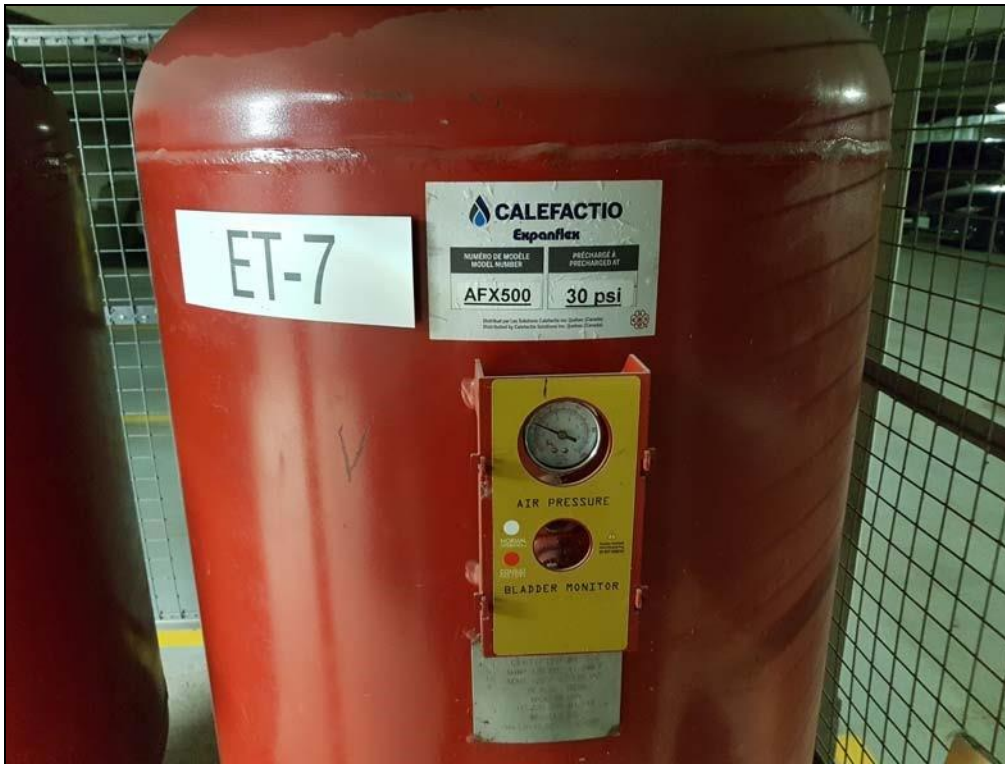
Réservoir d'expansion ASME CALEFACTIO AFX 500 2019.
