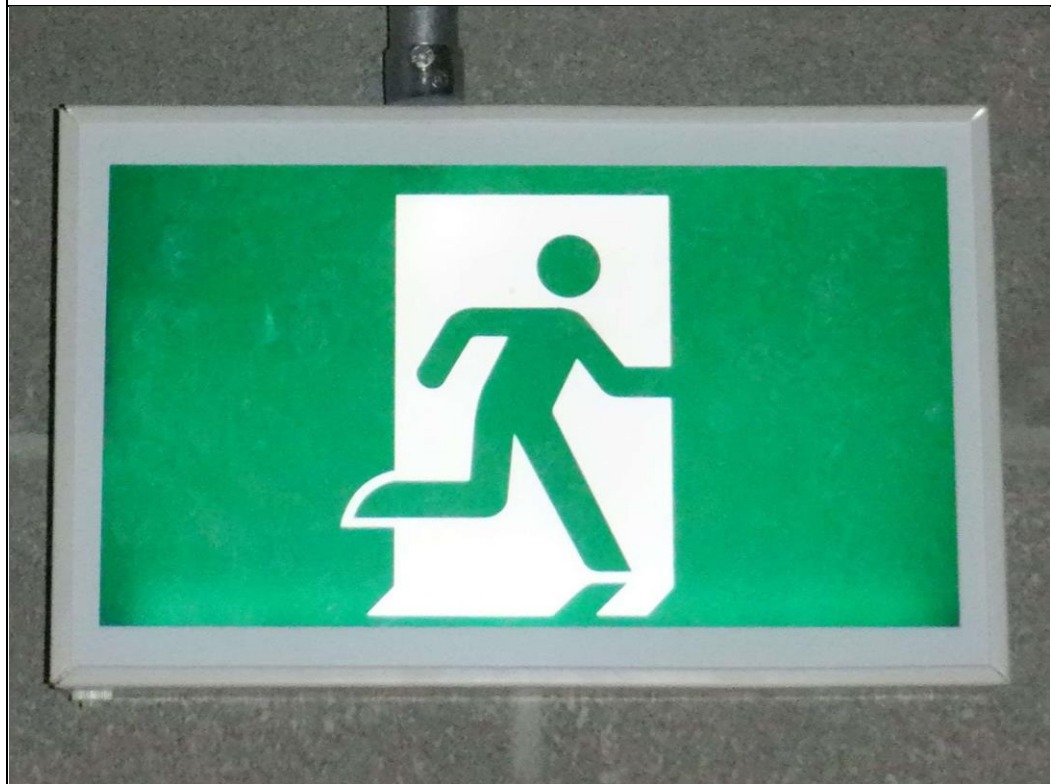
Appareil d'éclairage marqué 'sortie' avec direction, monté au mur.
