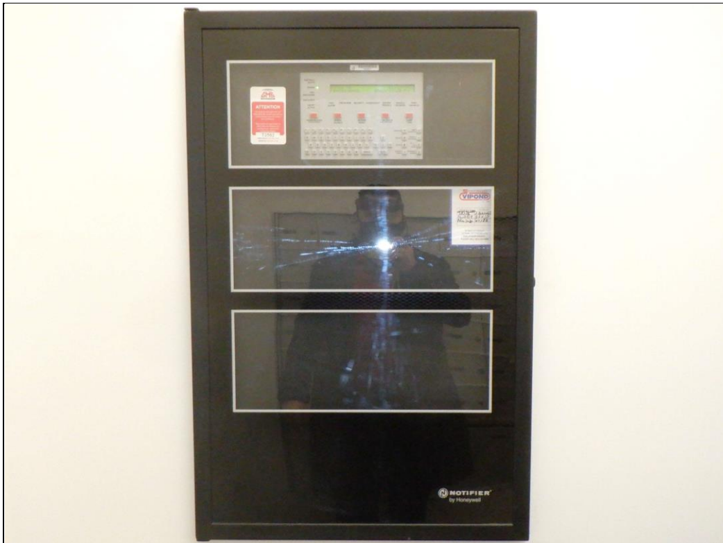
Panneau d'alarme incendie de marque Notifier by Honeywell installé par Vipond.
