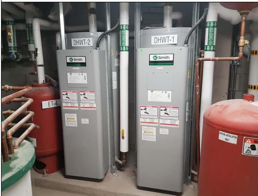
Réservoir d'eau chaude 600v 3 phases 4000W total 24000W 6 éléments AO Smith, DRE-80 100.
