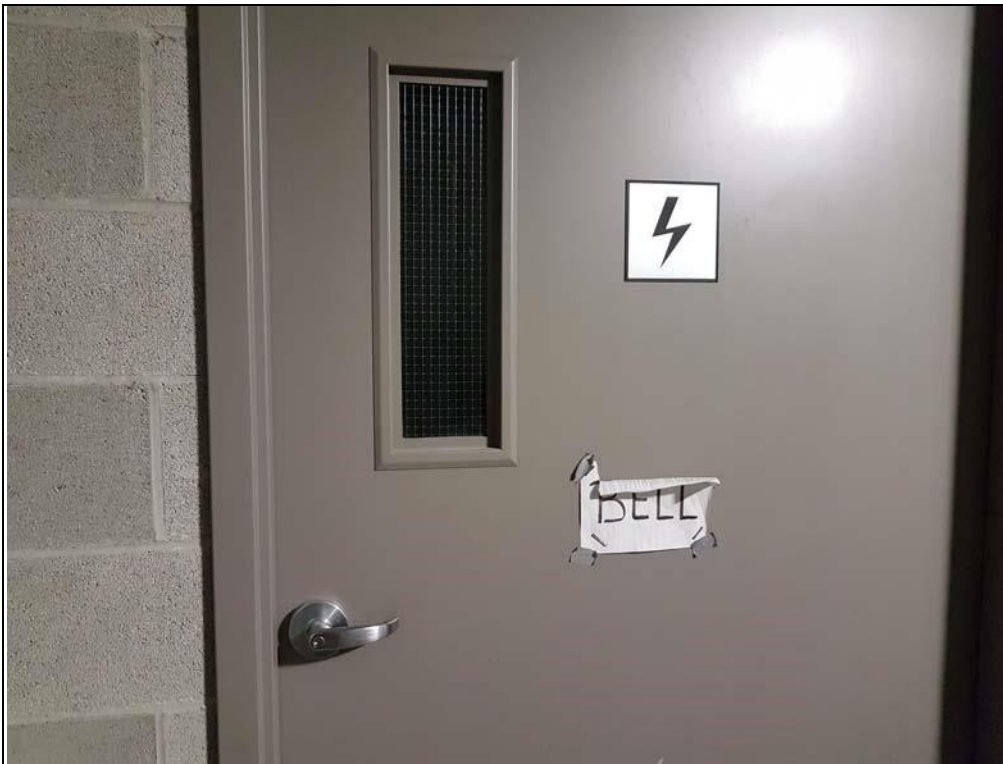
Porte chambre électrique P-2.
