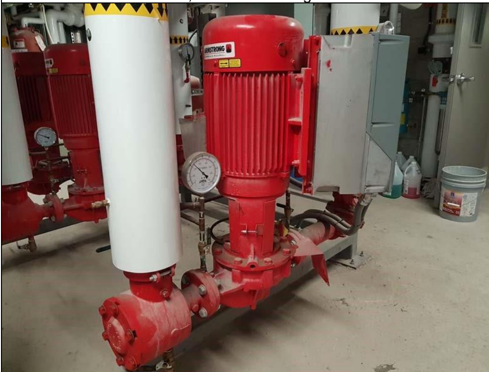
Pompe 175 PSI 200F° 575V 3HP 60hz Armstrong 4300IVS 0208-020.0 avec contrôleur de pompe Armstrong IVS 102 DEPC.
