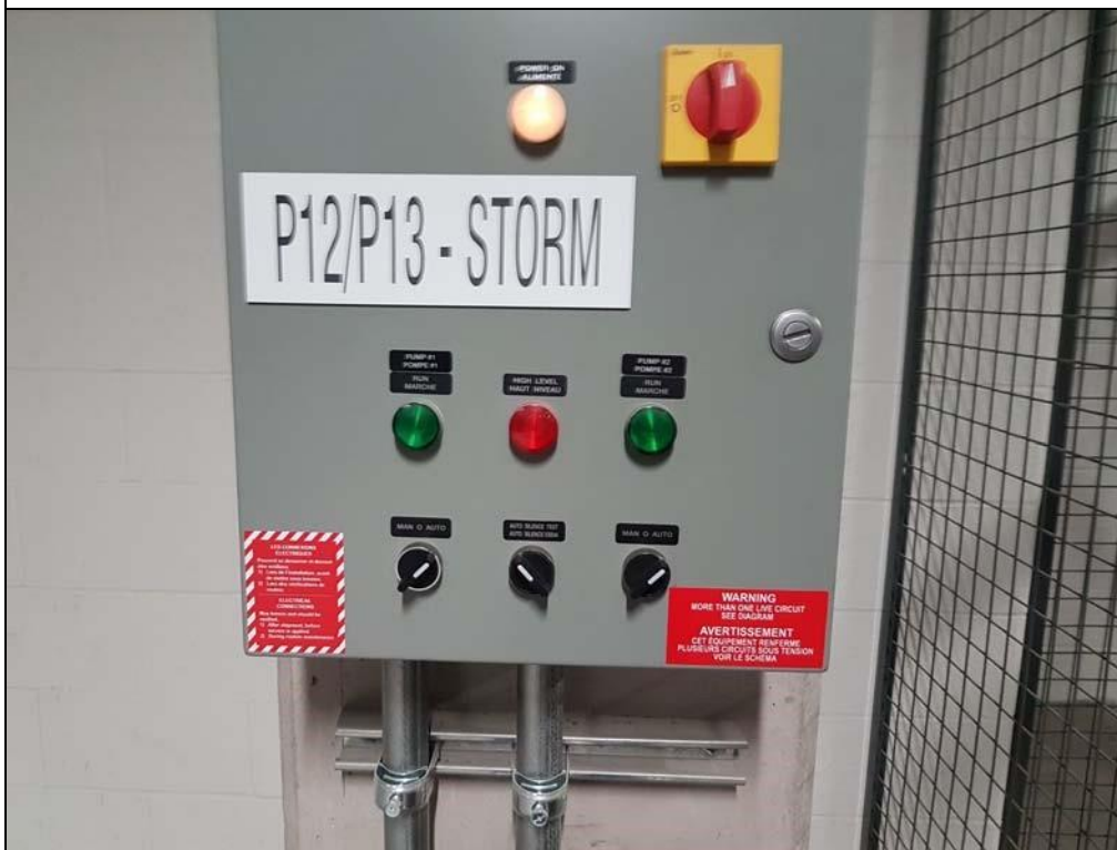
Contrôle des pompes submersibles.
