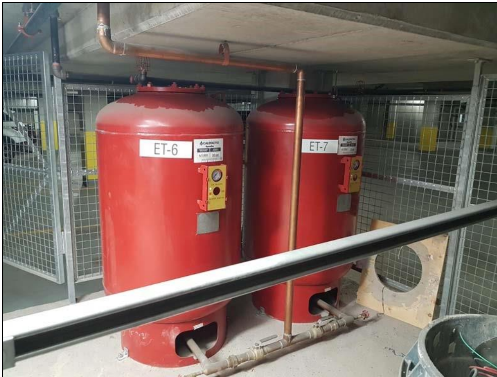
Vue générale des 2 réservoir d'expansion.
