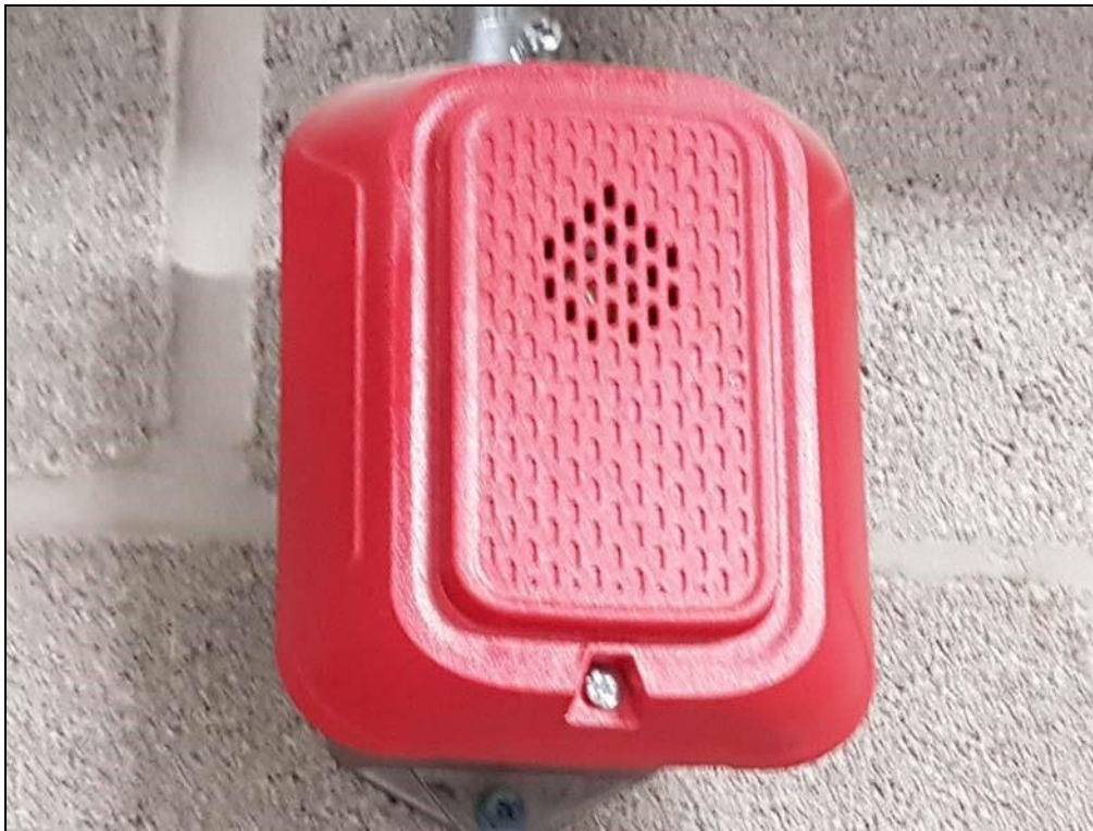
Klaxon d'alarme incendie.
