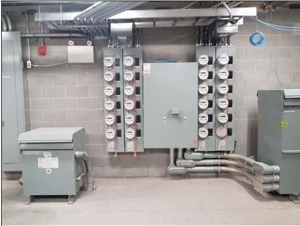
Vue du mur de gauche dans la salle électrique au niveau P-2.
