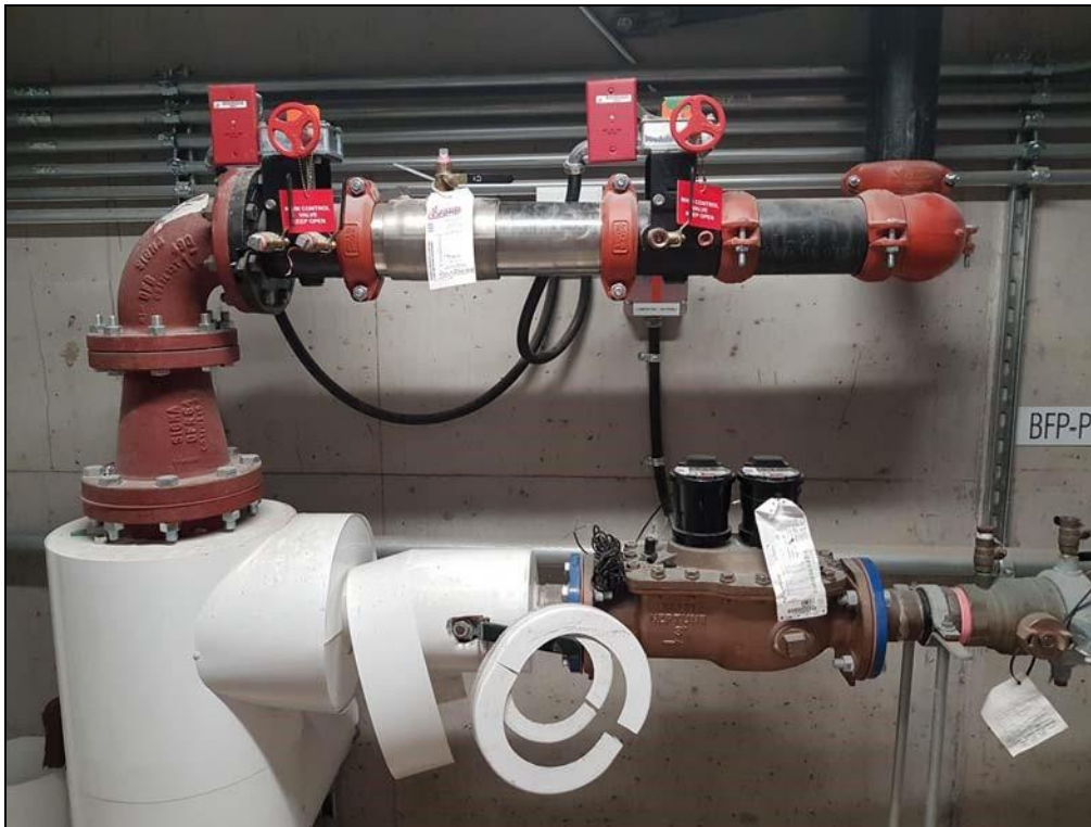
Vue générale de l'entrée d'eau avec le séparateur pour les sections incendies et aqueduc.
