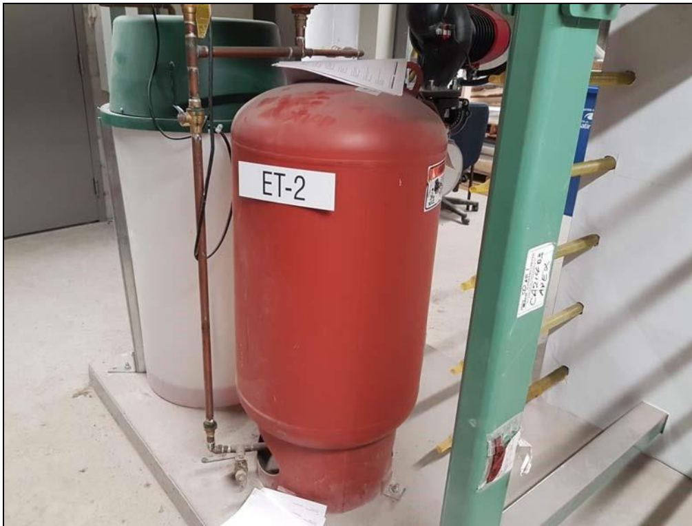
ET-2 Réservoir à vessie à expansion verticale de 45 gal TACO CBX170-125.
