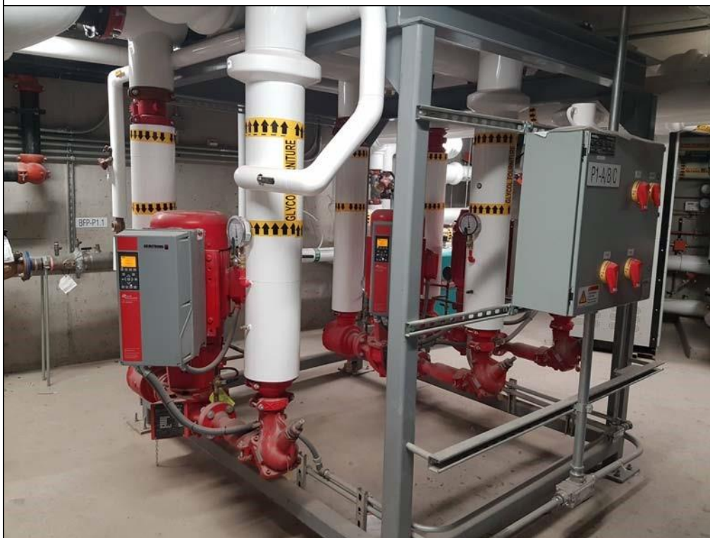
Vue générale Salle mécanique.
