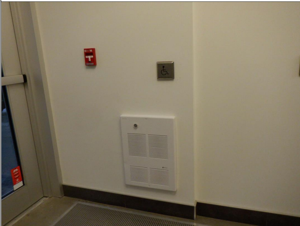
Entrée avant. Chauffage de 4000W aéroconvecteur Ouellet et Station manuelle.
