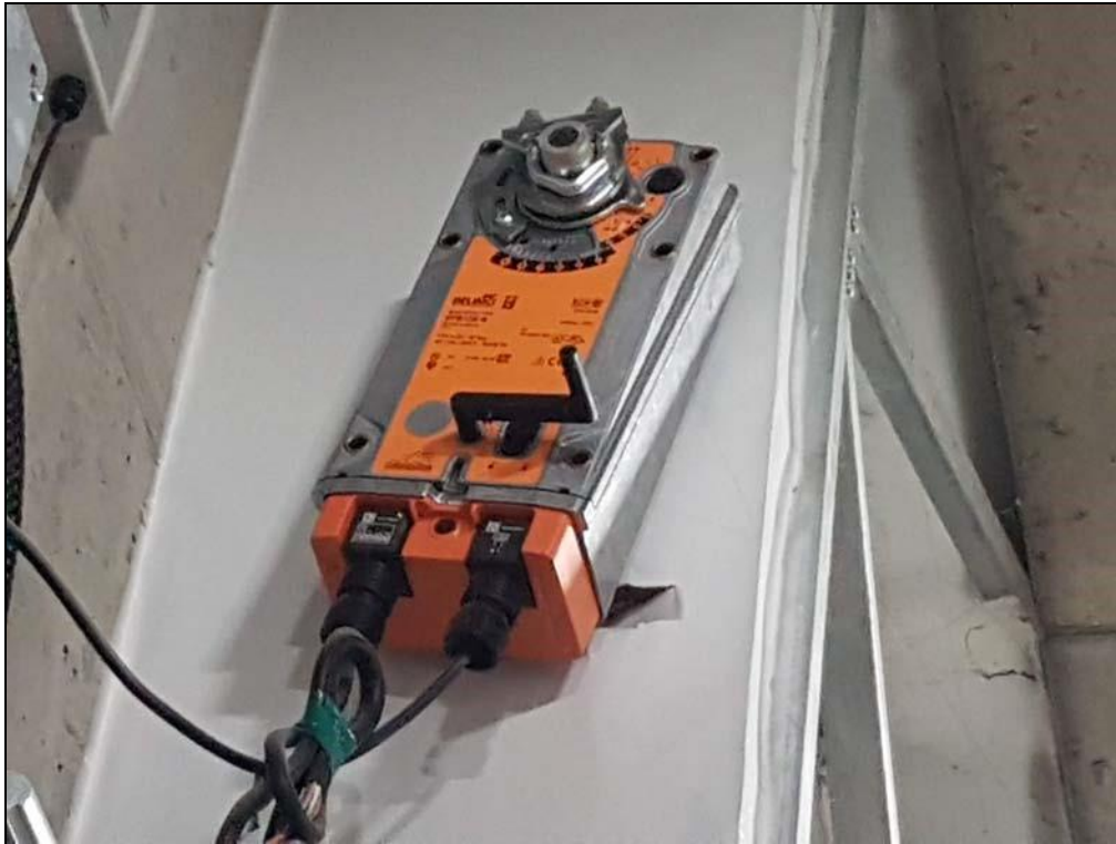
Contrôle des volets au-dessus des portes de garage. Model à vérifier.
