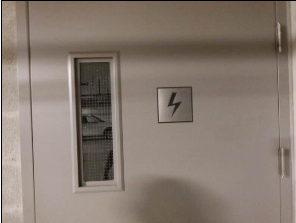
Salle électrique P-1.
