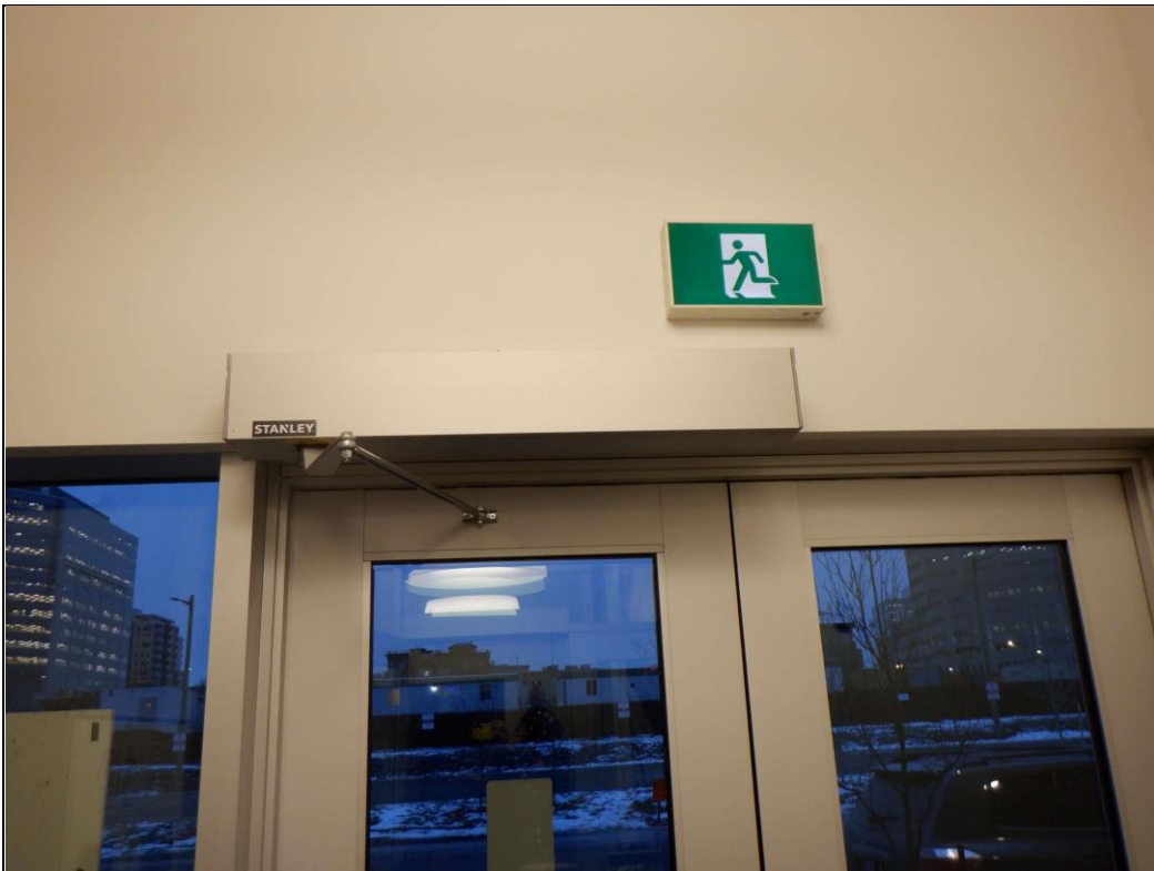
Enseigne de sortie de secours et ouvre porte automatique Stanley.
