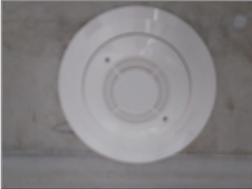
Détecteur de fumé.
