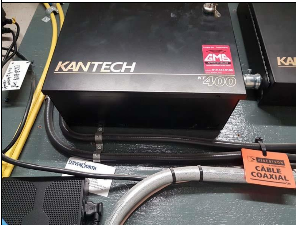
Contrôleur quatre portes Kantech KT-400 compatible Ethernet.
