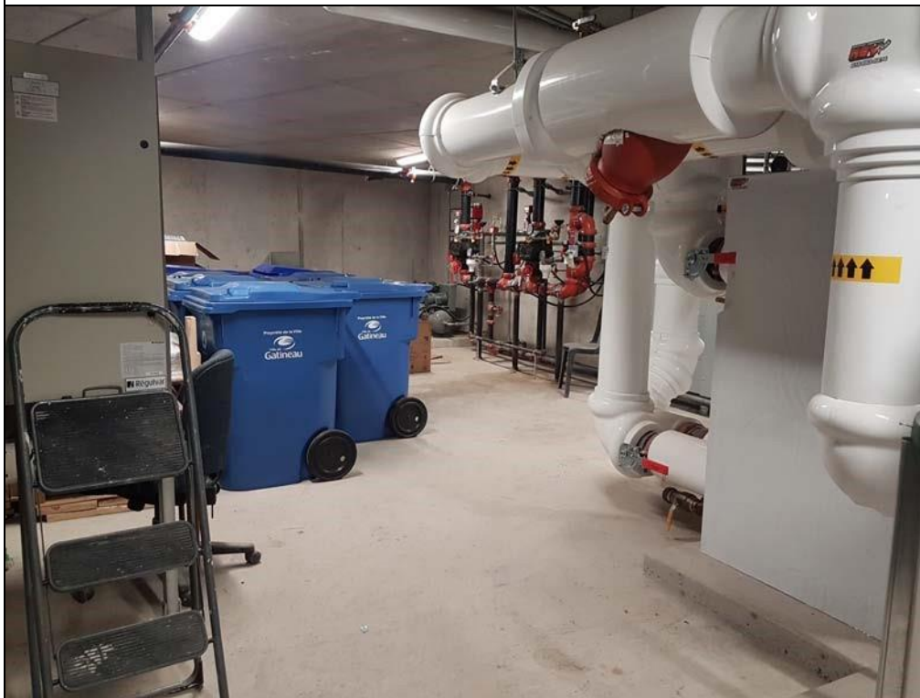
Vue générale Salle mécanique.
