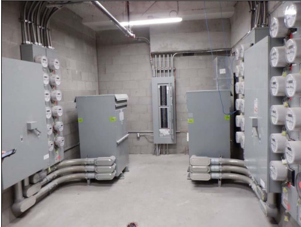
Vue générale de la salle électrique P-1.
