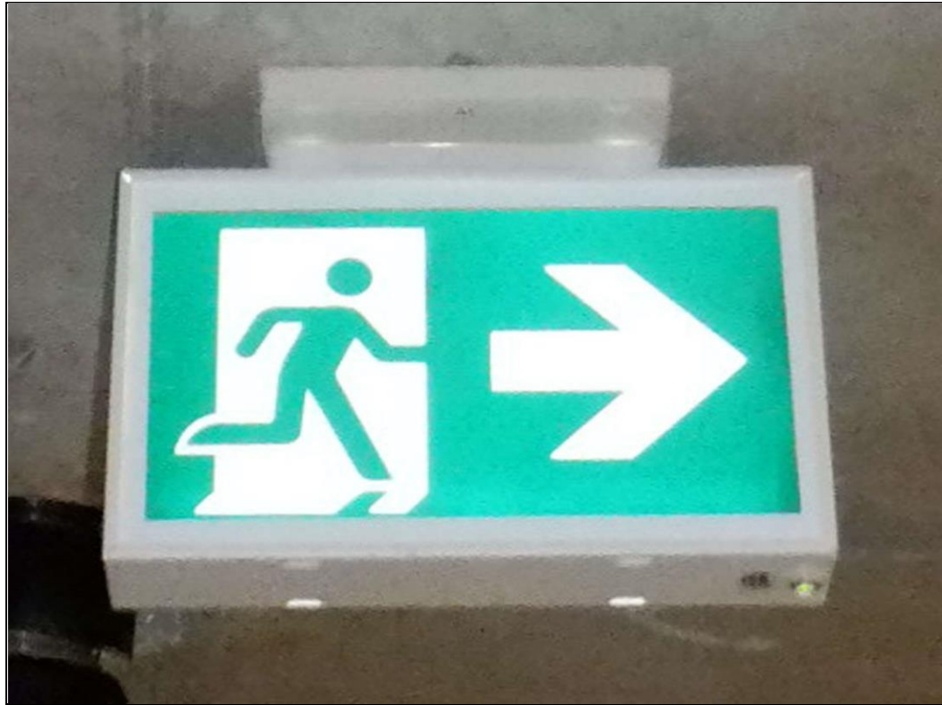
Appareil d'éclairage marqué 'sortie' avec direction, monté au plafond.
