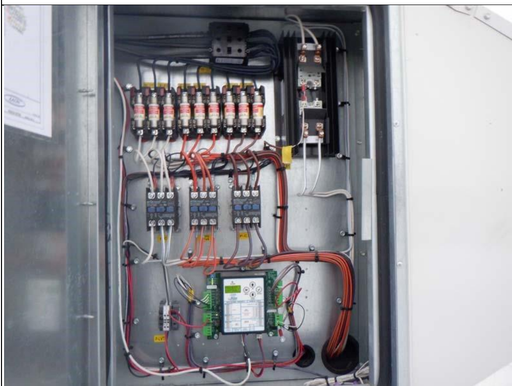
Panneau de fusibles.
