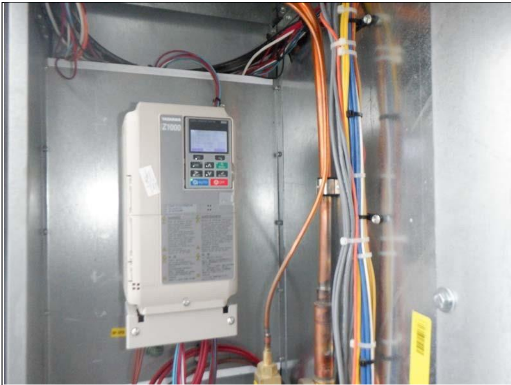
Variateur de fréquence Z1000 Yaskawa pour Unité de chauffage et refroidissement au toit AAON.
