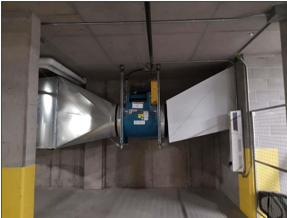
Ventilateur du garage (sortie) à entrainement par courroie TCVA AXIFAN TWIN CITY FAN TCVA 28B5. Niveau P-2.
