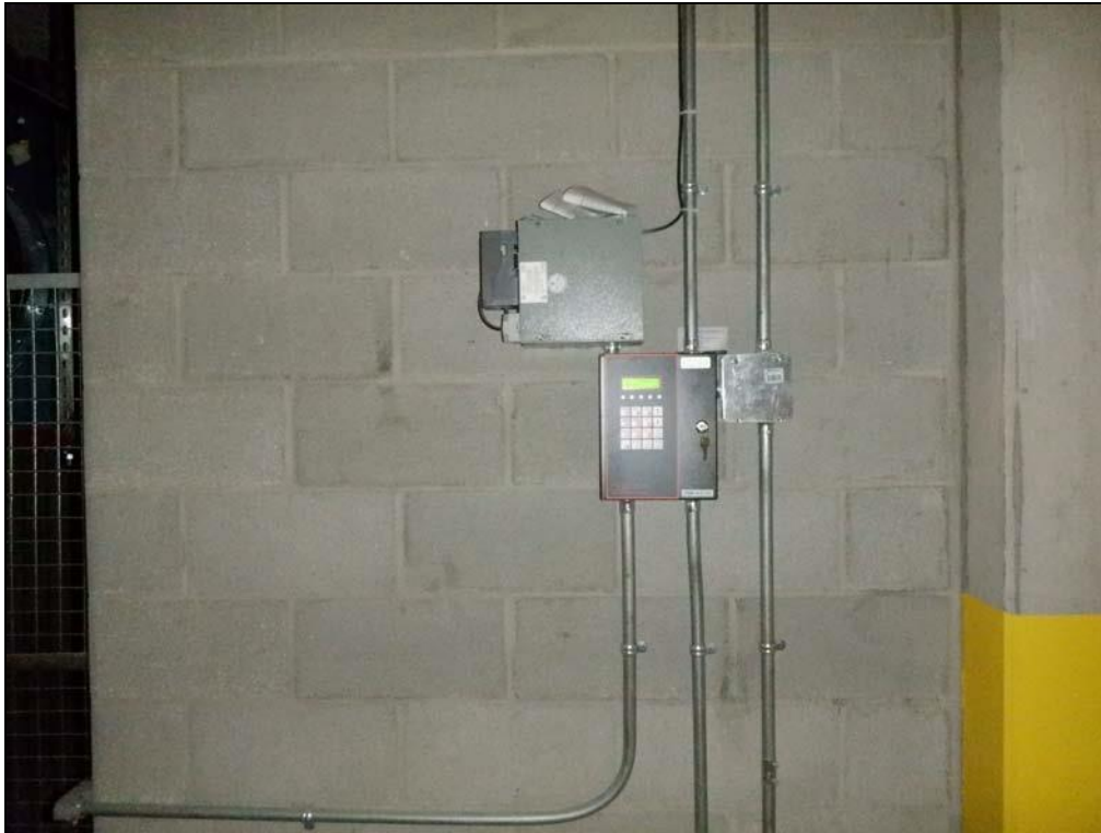
CO/Nox Master control Série QEL M-Controller.
