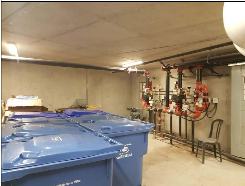
Vue générale du système principale de Gicleur.
