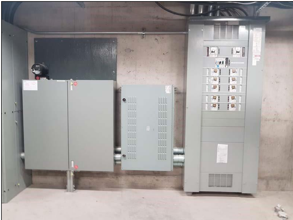
Vue du mur de droite dans la salle électrique au niveau P-2 Panneau. CDP 347/600 Panneaux de distribution Pow-R-Line 4 à compteur multipoints Power Xpert EATON.
