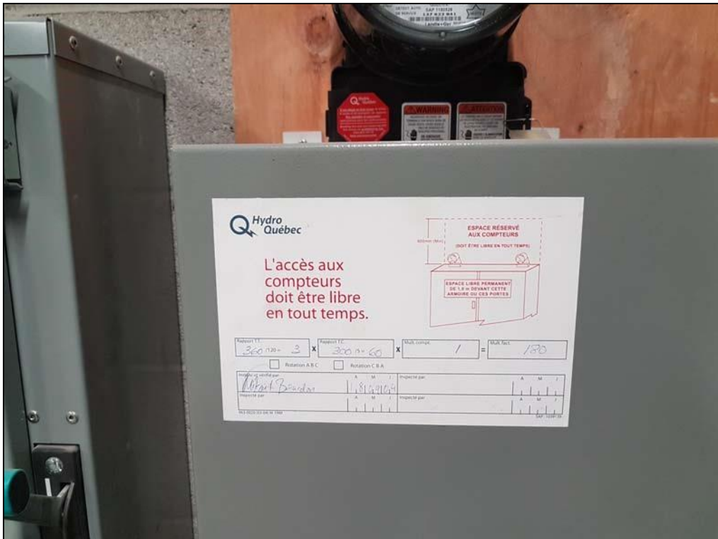
Boîtier et compteur Hydro-Québec.
