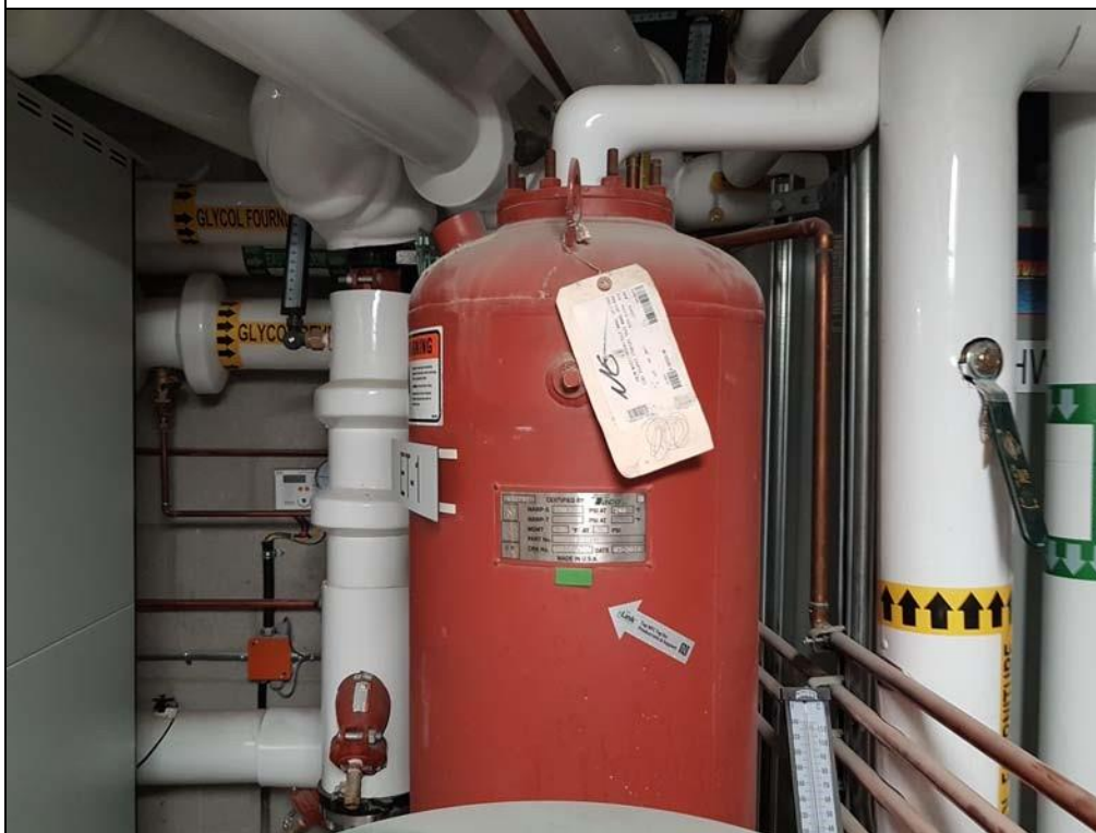
ET-1 Réservoir à vessie d'expansion d'eau potable de 45 gal TACO CBX170-150.
