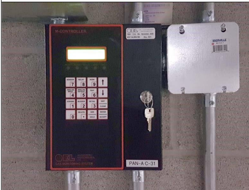
CO/Nox Master control Série QEL M-Controller.
