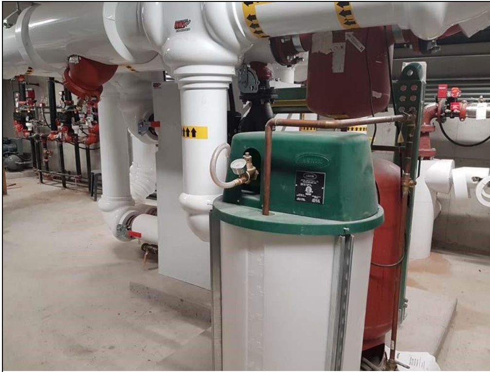
Vue générale Salle mécanique.
