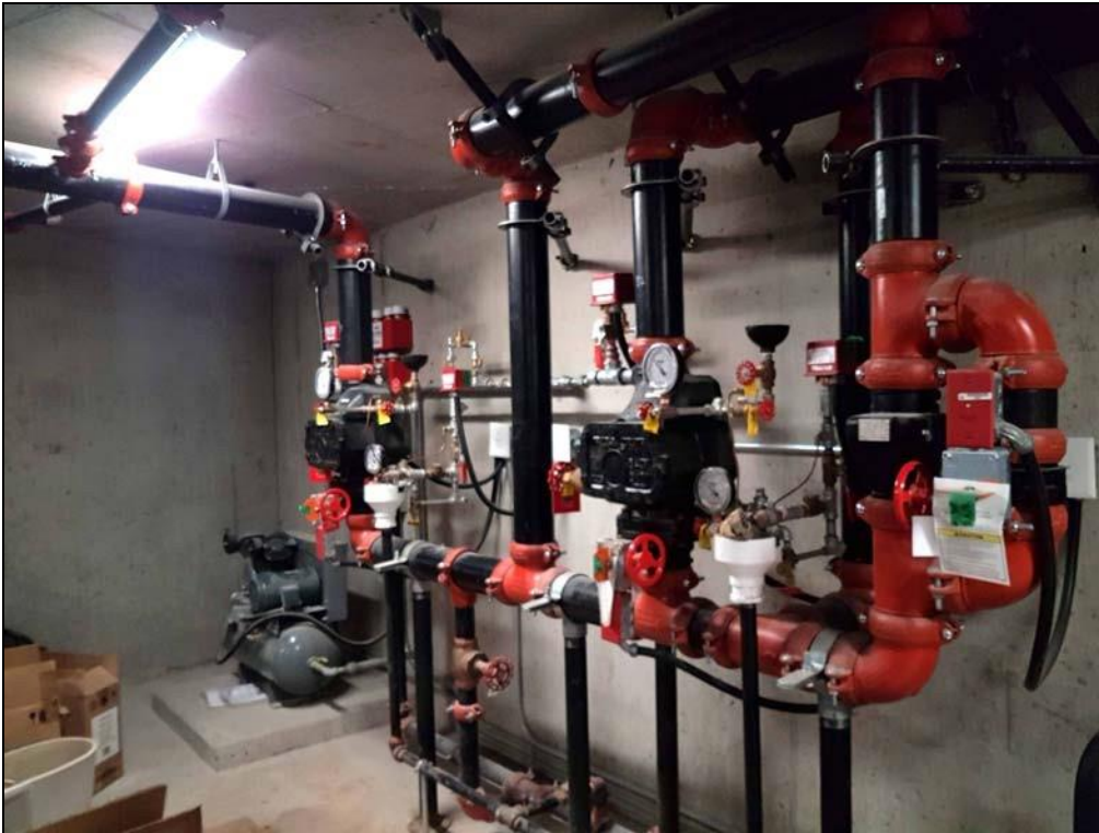
Vue générale des composantes Vipond.
