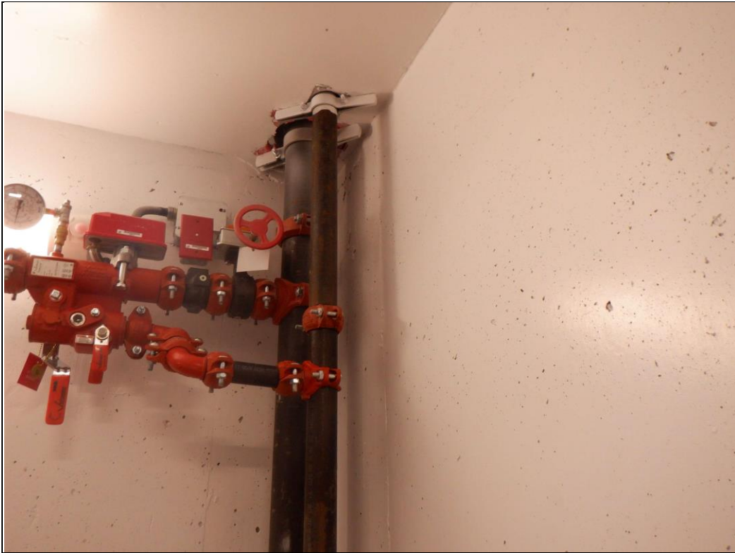
Contrôle intermédiaire du système incendie.
