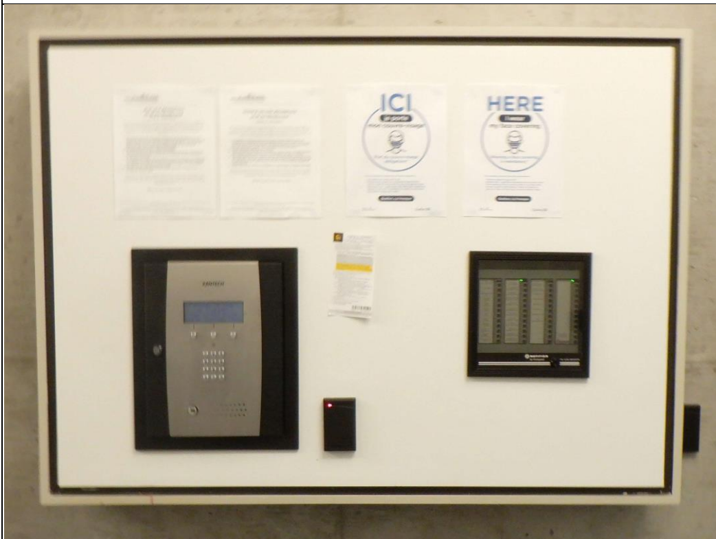
Intercom et panneau d'alarme des gicleurs Notifier by Honeywell.
