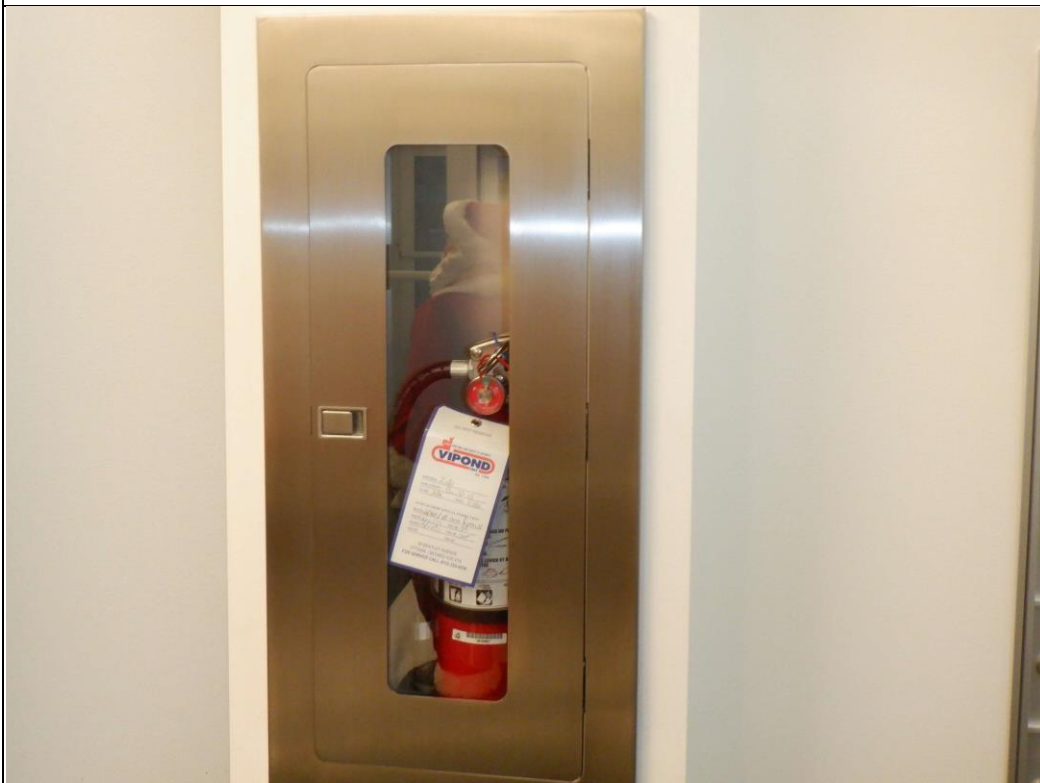
Boîtier pour extincteur.
