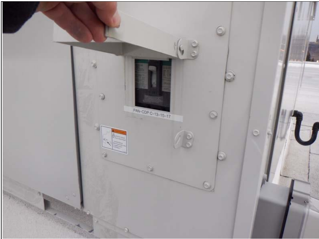
Interrupteur principale de l'appareil au toit.
