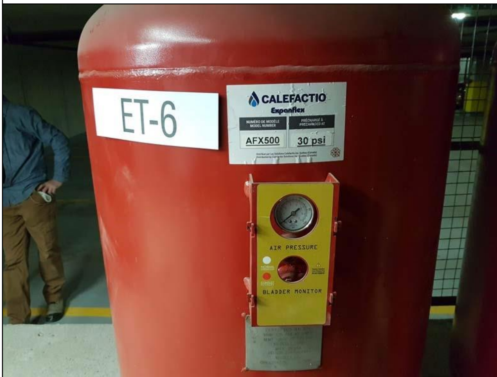
Réservoir d'expansion ASME CALEFACTIO AFX 500.
