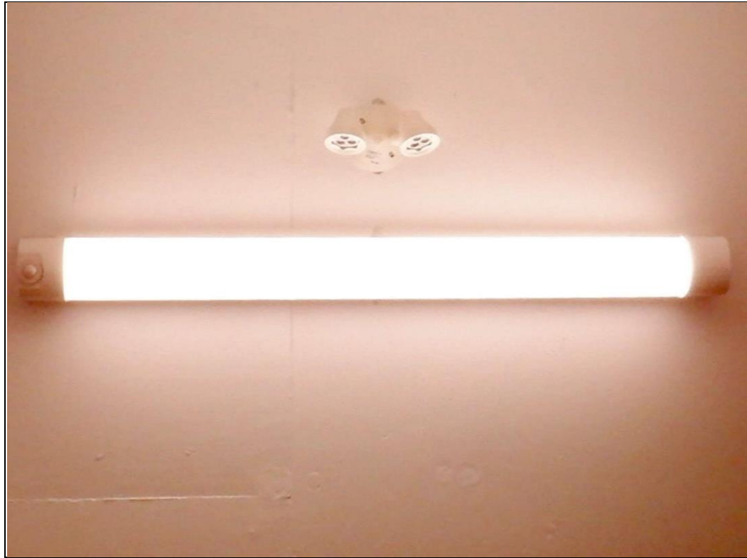
Néon dans les cages d'escaliers.
