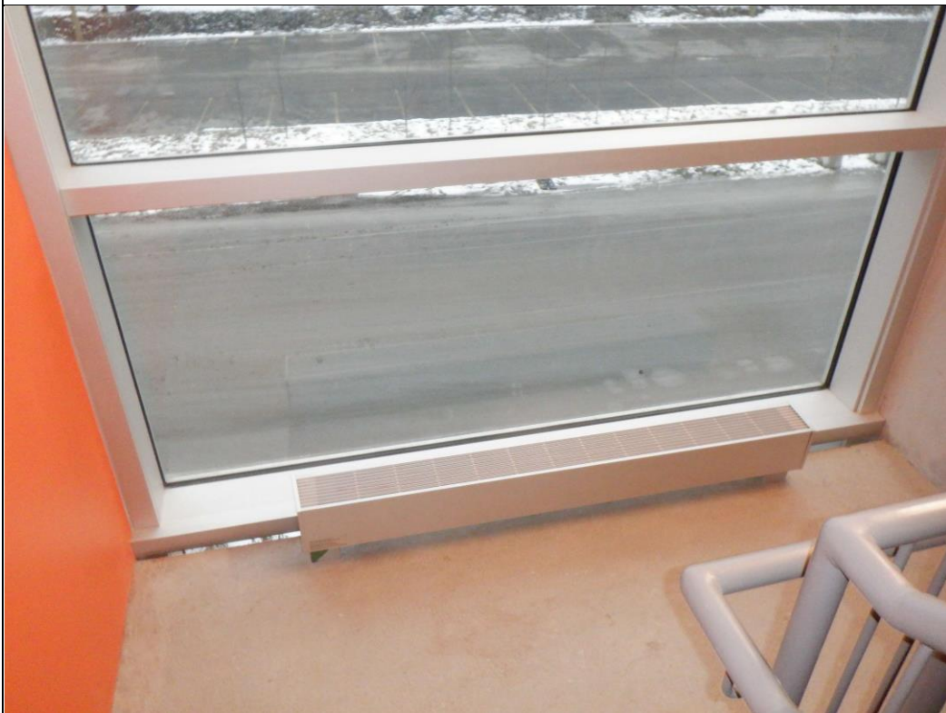
Chauffage de l'escalier avant. Plinthe électrique carrée en aluminium de 1275W.
