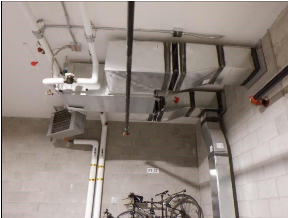
Unité de chauffage HP-P1.3, heat pump W.GS.H.019.B1.E.GL.R DAIKIN GSH.
