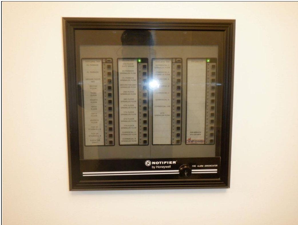
Panneau d'alarme des gicleurs Notifier by Honeywell.
