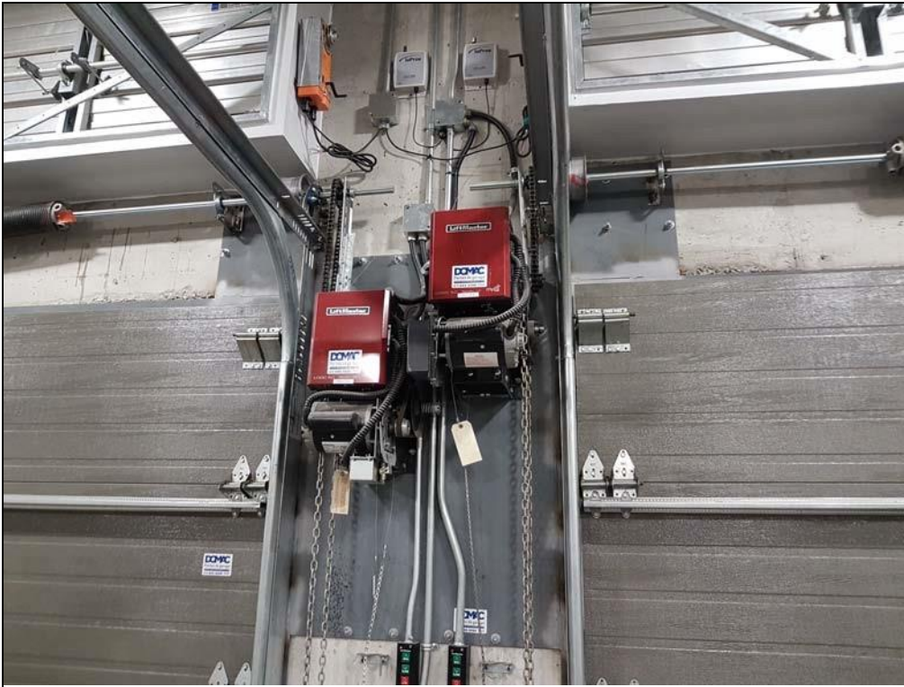
Vue générale des accessoires de porte.
