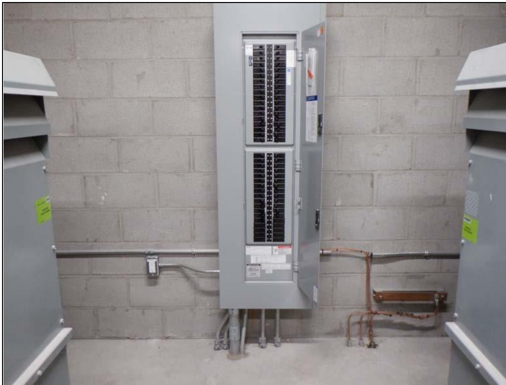
Panneau électrique B 120/208 Panneaux Pow-R-Line C, Eaton P1aL4A2-72.
